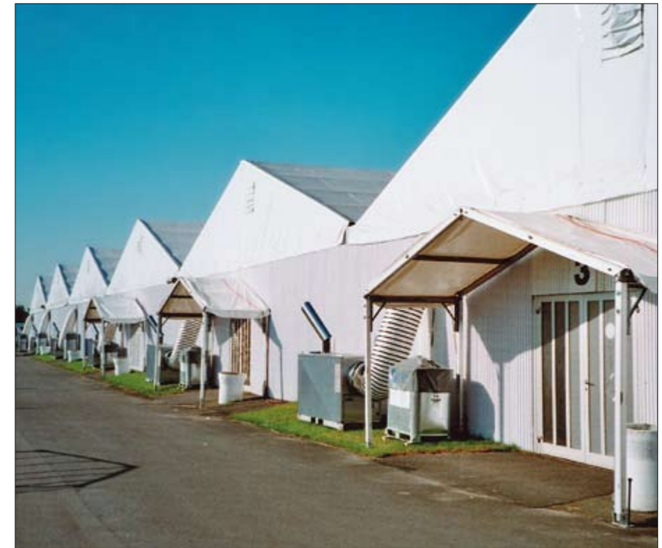
Beheizung von acht Messezelten mit einer Ausstellungsfläche von 7.500 m 2 – NORLA/Norkofa-Messegelände, Rendsburg
