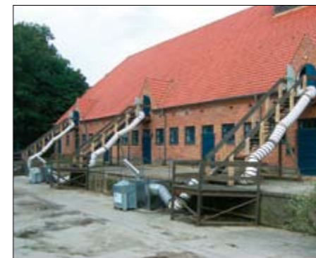
Beheizung einer Veranstaltungsscheune auf Gut Altenhof bei Eckernförde
